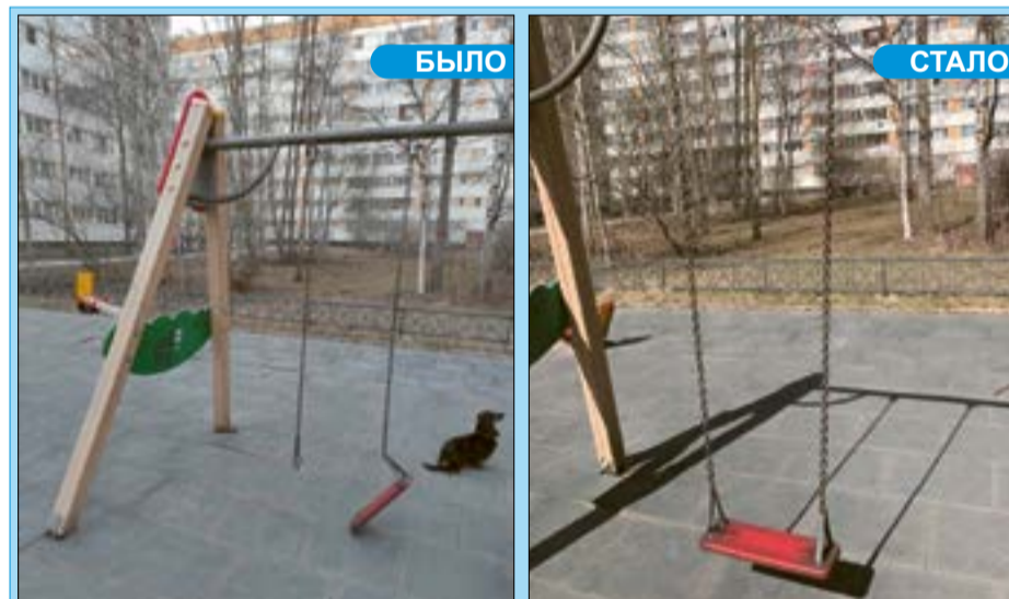
Ремонт игрового оборудования на детской площадке по адресу ул. Зины Портновой, 21 корп. 2.
